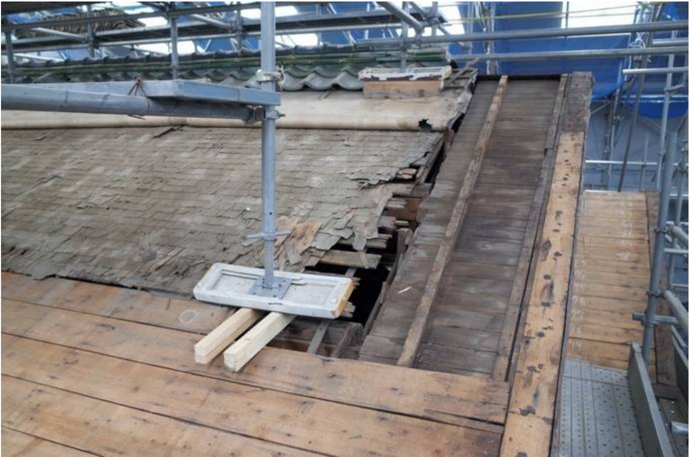
写真は、二階南面になります。 この部分は雨漏りがあり、以前も野地板が合板で修理されていました。
