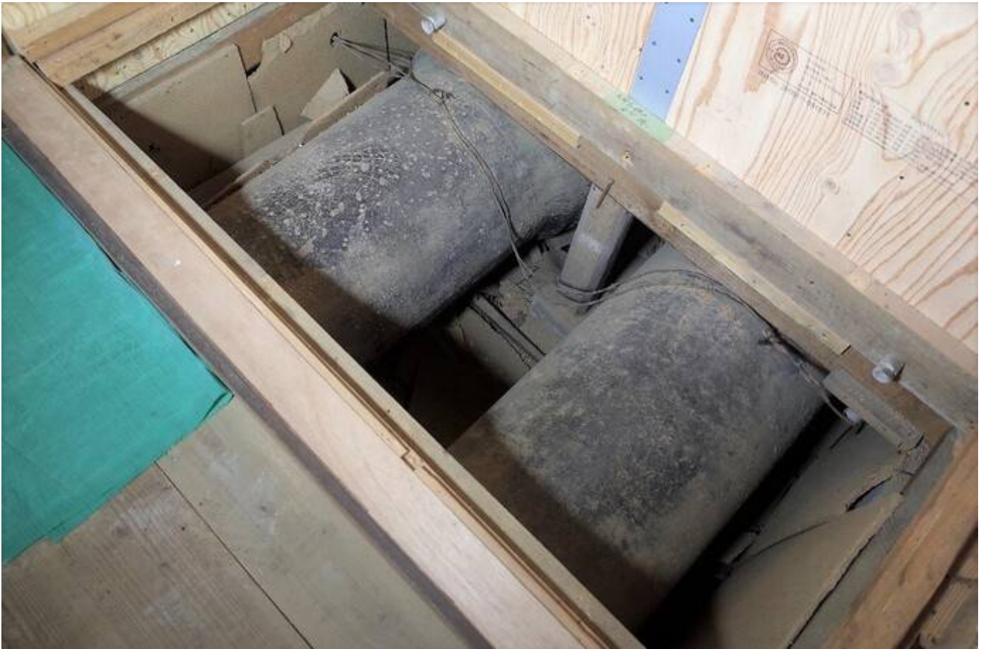
附上屋 温水暖房用土管確認 端部は確認できませんが、往復分と考えています。
